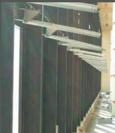
Su serramenti a vasistas esterni con allaccio ad impianto di aria compressa
